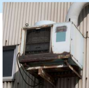
大型の排熱設備
